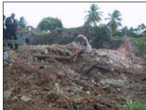
Beispiel einer Baustelle, auf der stark korrodierte Gasflaschen aufgefunden wurden, die ursprünglich giftiges Gas enthielten.
